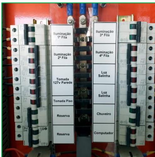
Foto nº 5 – Identificação de circuitos elétricos
